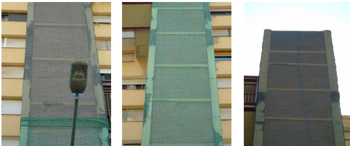
Figura 7. Despreniments i fissures als fulls de maons
