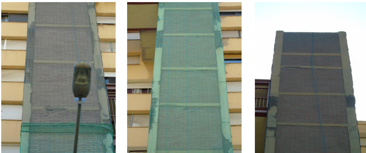
Figura 7. Despreniments i fissures als fulls de maons
