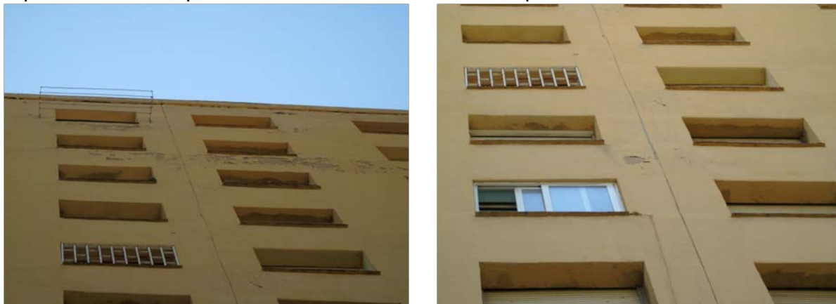
Figura 9. Acabat pintat amb pèrdues de material locals.
