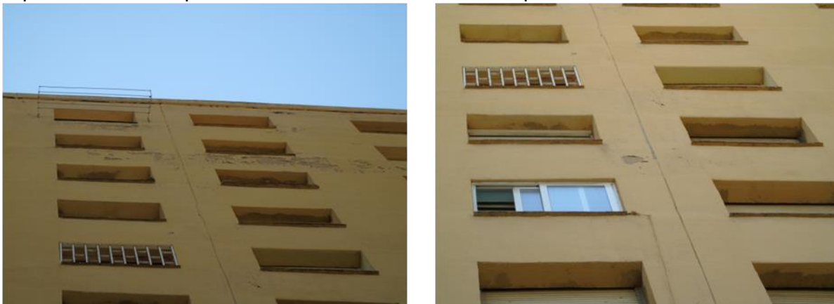
Figura 9. Acabat pintat amb pèrdues de material locals.
