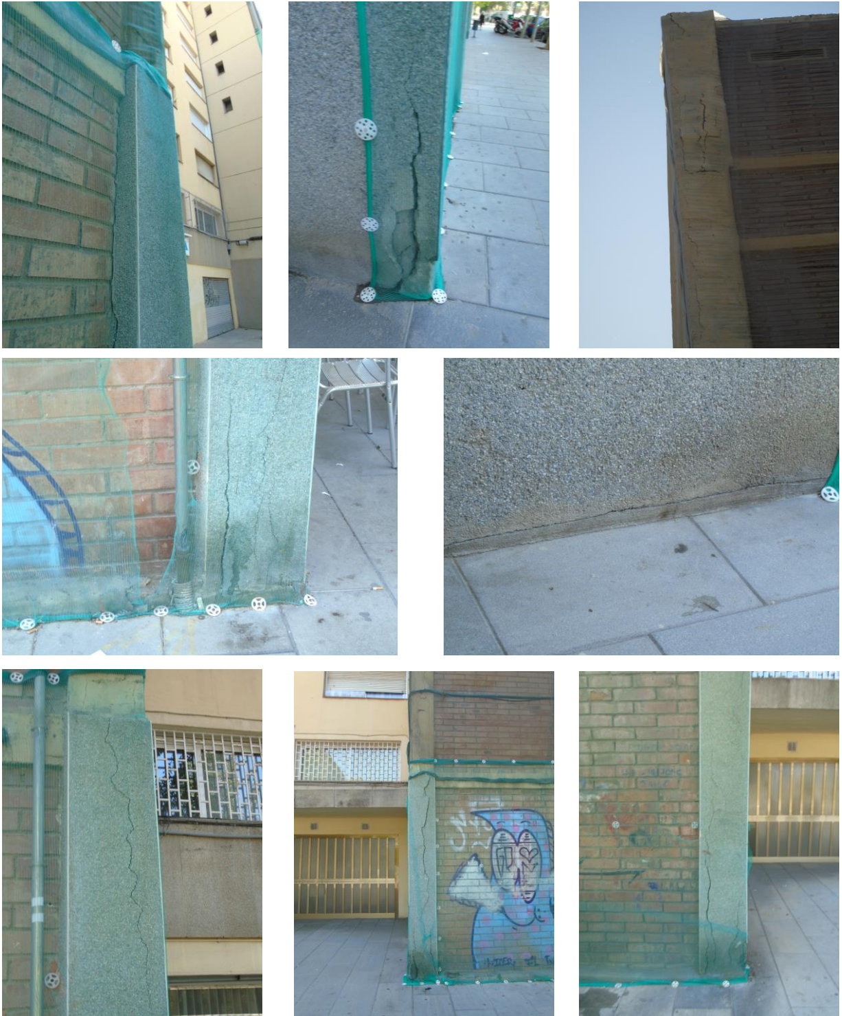
Figura 6. Fissures i esquerdes a les caixes d'escala
