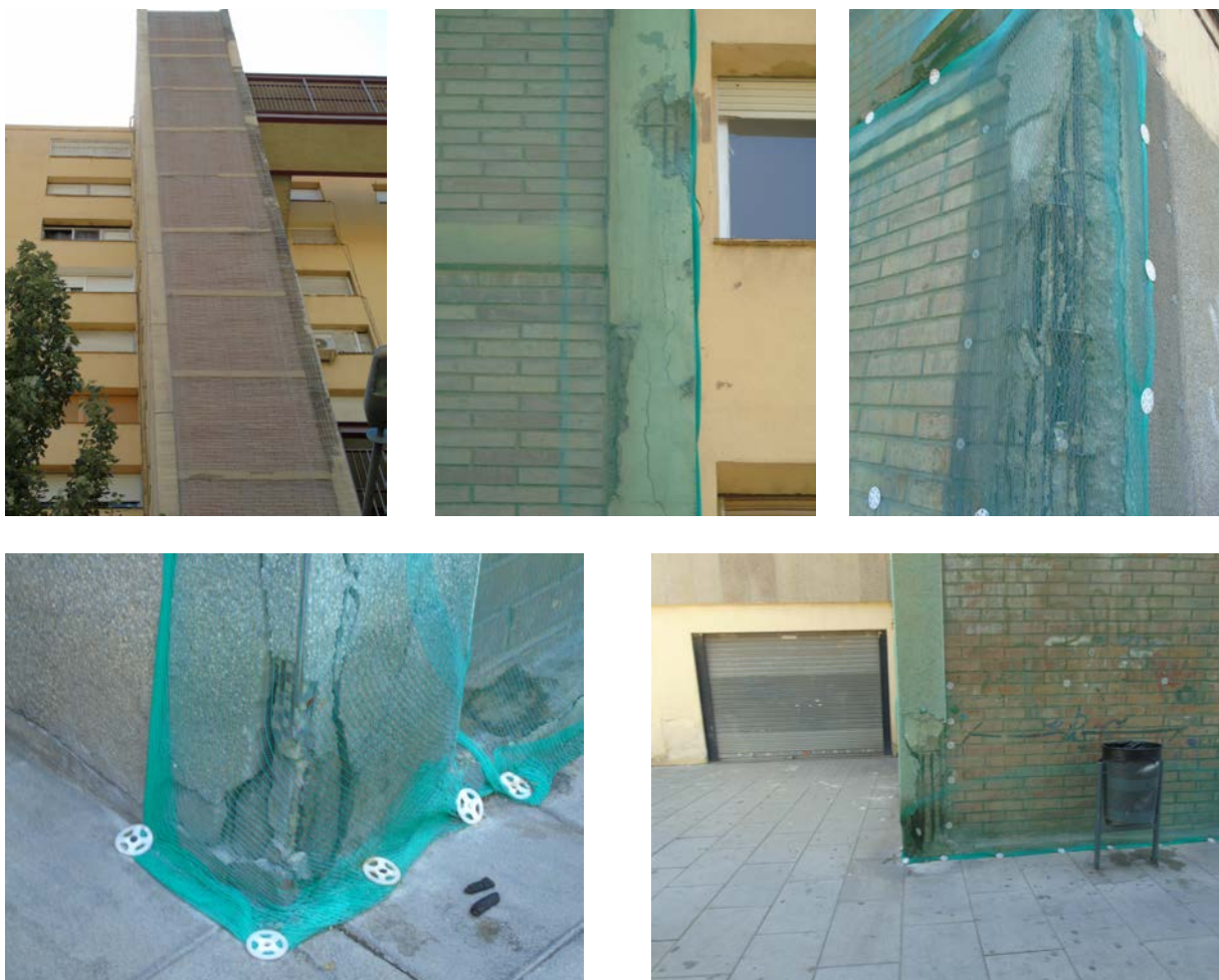
Figura 6. Desprendiments a les caixes d'escalas
